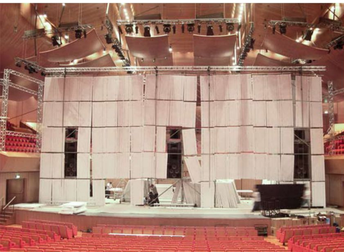
↑ Particolare dei pannelli acustici allestiti nella Sala Santa Cecilia dell'Auditorio Acoustic panels in the Sala Santa Cecilia in the Auditorium
